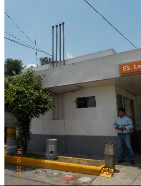
Fotografía 9 Tuberías de venteo
