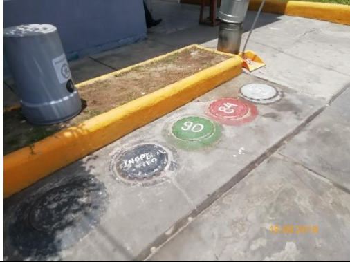
Fotografía 8 Bocas de llenado remoto
